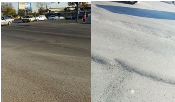
3 -rasm. Toshkent halqa yo'lidagi qoplamadagi deformatsiyalar.
