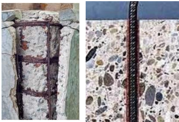
4-rasm. Beton va armatura o'rtasidagi bog'lanishning yo'qolishi
