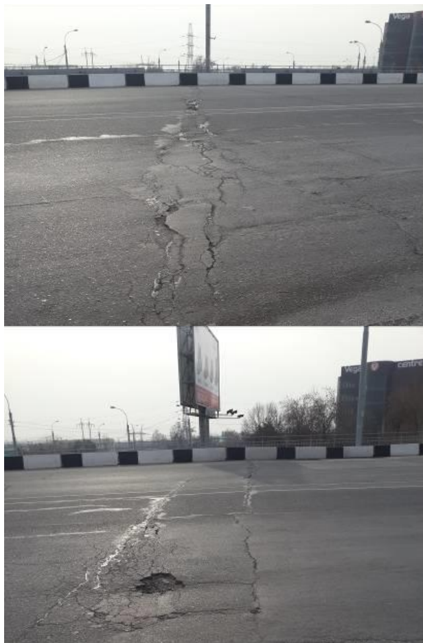
Рис. 1. Повреждения ДШ закрытого типа
